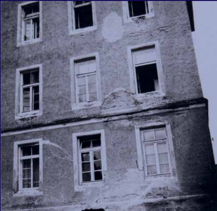
„Der neue Zögling geht oder fährt über einen schlechten, leider nicht staubfrei gemachten, dauernd zu flickenden Zufahrtsweg zum Heim. Er kommt vorbei am Gebäude Josefinum, dessen Fassade sich wie in Bild 1 erkennbar darbietet.“
