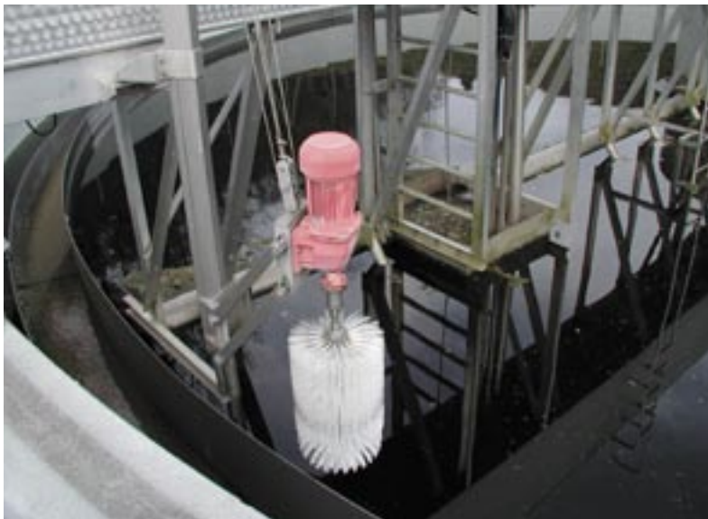
Abwasserreinigung auf dem Niveau des Standes der Technik – das Sachgebiet Siedlungs- und Industriewasserwirtschaft kontrolliert, informiert, überwacht und berät.
